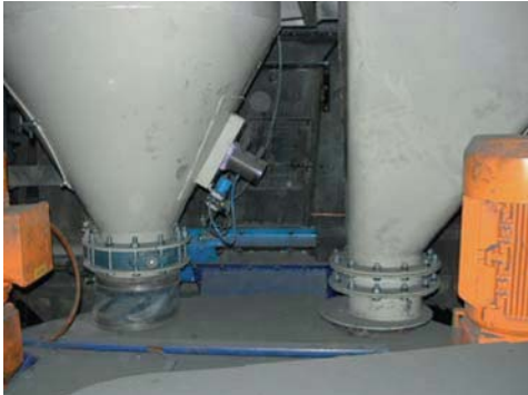
Abreinigen von festen Anbackungen mit Druckluft-Kolbenvibratoren
